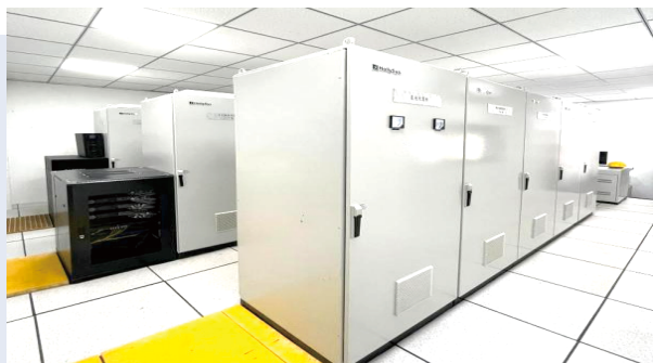
DCS控制机房
