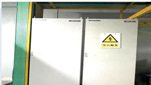
中控DCS控制柜
